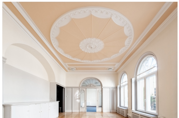
Stuck an der Decke
